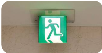
避難口誘導灯（避難口がわかる）
